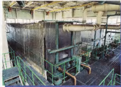
⑥ フィルタープレス脱水機
