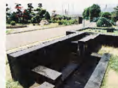
放流監視水槽
