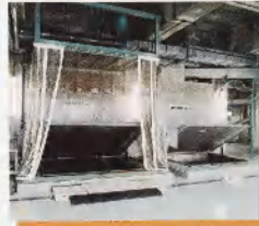
⑨ 脱水汚泥・乾燥汚泥投入ホッパ
