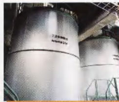
⑮ 二次発酵槽 堆肥化をさらに安定化するために約30日間かけて二次発酵させます。
