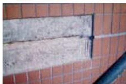
タイルの目地はあるが、躯体には打ち継ぎ部の目地が無いことが判明
