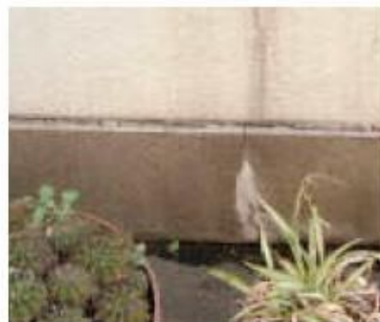
モルタル製の幅木部分。上端部にすき間ができ、雨水が浸入。ひび割れ部分にはエフロが発生
