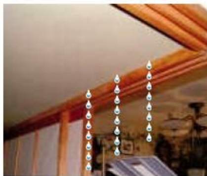
ルーフテラスと居室の境界付近の直下で漏水が発生した
