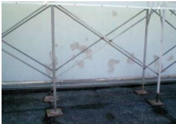
外壁の吹き付けタイルが一部はがれていることはしばしばある
