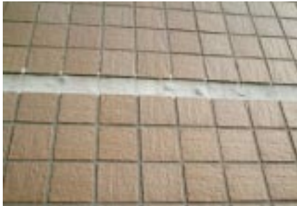
ウレタン系のシーリング材を露出したため、紫外線によるひび割れなどの劣化が起きた
