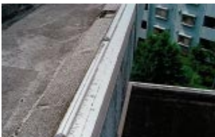
パラペットの上端にある笠木が外壁を汚れやすくしていた
