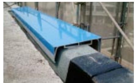
外壁を塗り替えるのに合わせて、笠木を交換。外壁を汚れにくくした
