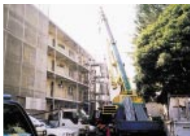
既存のS造階段をクレーンで移設。工事中の仮設避難階段とした
