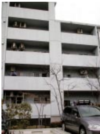
改修前の外観。淡い青の有機系塗料(アクリル系吹き付けタイル)が使われていた。十数年を経て、つやがなくなり、退色し、雨すじ汚れが多く見られた
