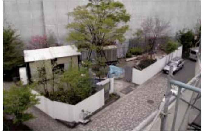
仮設建物をマンションの敷地内に設置した状況。左から、危険物置き場、資材置き場、仮設便所、廃材コンテナが並ぶ
