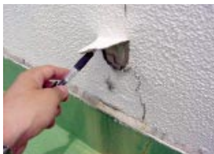
弾性塗料の一例。ひび割れから水が入って塗膜がはがれている
