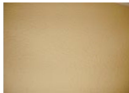
無機系のポリマーセメントモルタルにシリカ系の上塗りを施した塗装面
