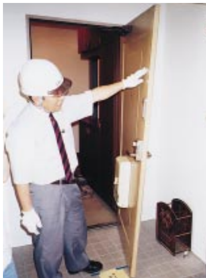
大きく変形した鋼製玄関扉。表裏2枚の鋼板を小口部分でスポット溶接していた箇所が外れた
